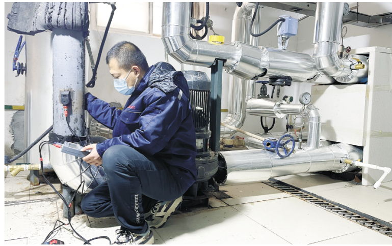
奎文区家乐苑小区换热站内,热企工作人员正在对供热设施进行调试。 潍坊日报社全媒体记者 赵春晖 摄
