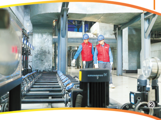
细测温，确保供暖期间电力不断档。
