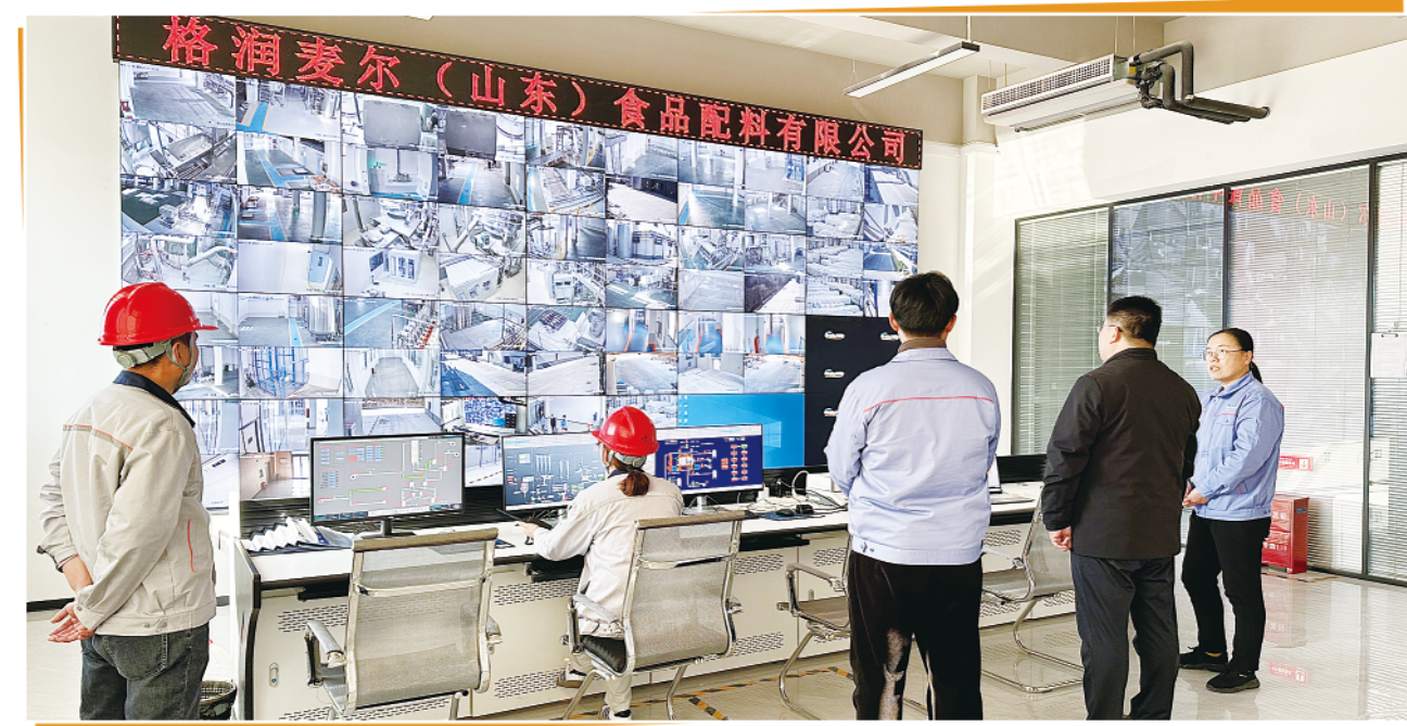
格润麦尔高端淀粉预混料智能制造项目主控制室。通讯员 刘玉娟 曹海涛 摄
