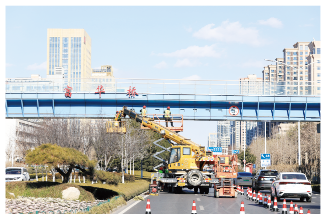
1月8日，在城区北海路上，工作人员正对过街天桥“富华桥”桥体进行检测，以保障桥体安全使用。春节临近，我市各相关部门抢抓时间，对公共设施开展安全检测，排除安全隐患，打造安全环境。 记者 巩建国 摄
