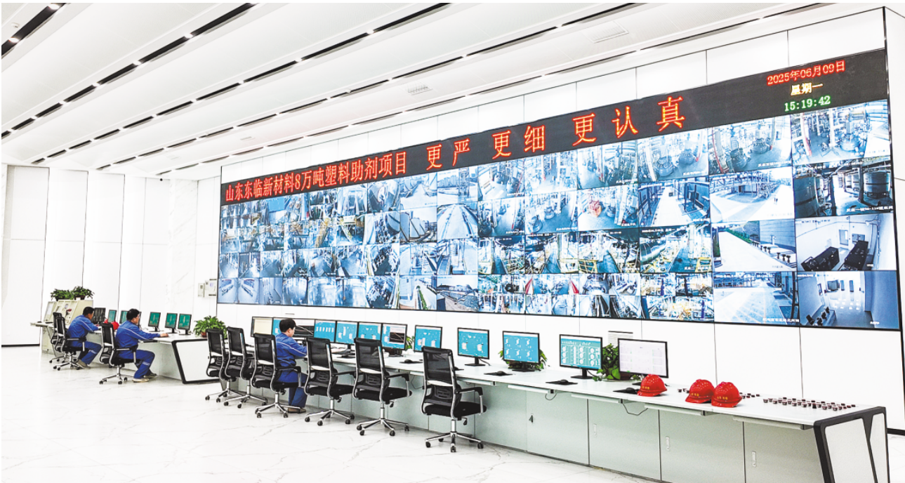
△山东东临新材料8万吨塑料助剂项目中控室(资料图片)。
