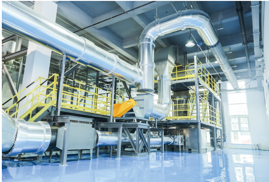
山东蓝想环境科技股份有限公司研发的工业循环水冷却换热测试实验平台。
