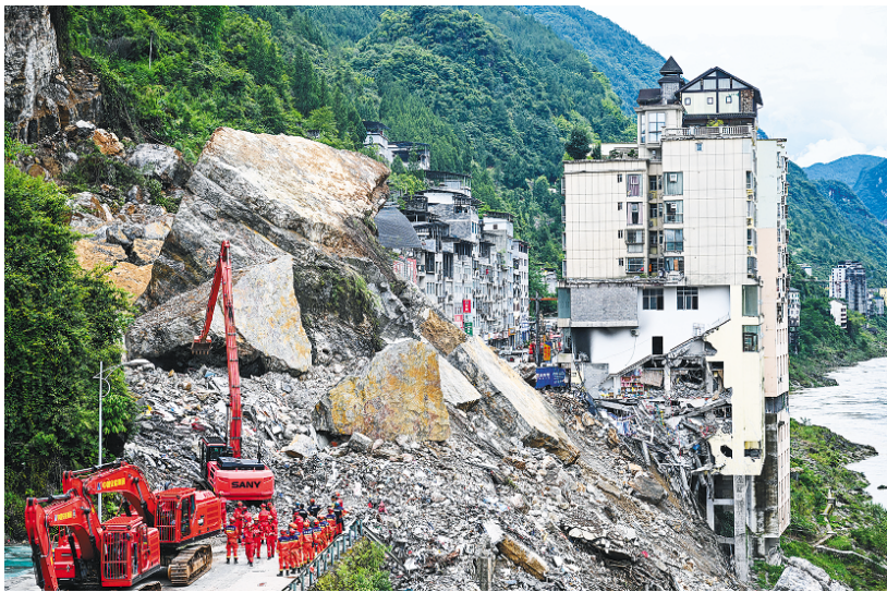
7月18日，救援人员在重庆彭水县山体崩塌现场救援。（新华社发）
